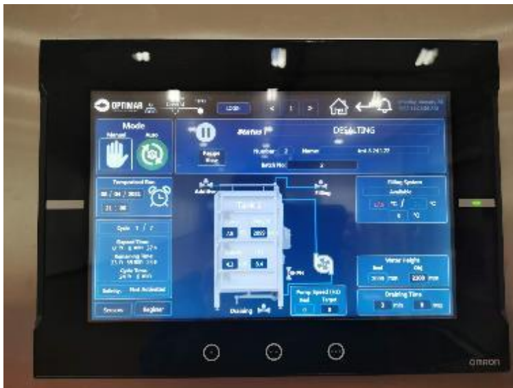
Figur 3 Panel for programmering og overvåkning av utvanningsprosessen
