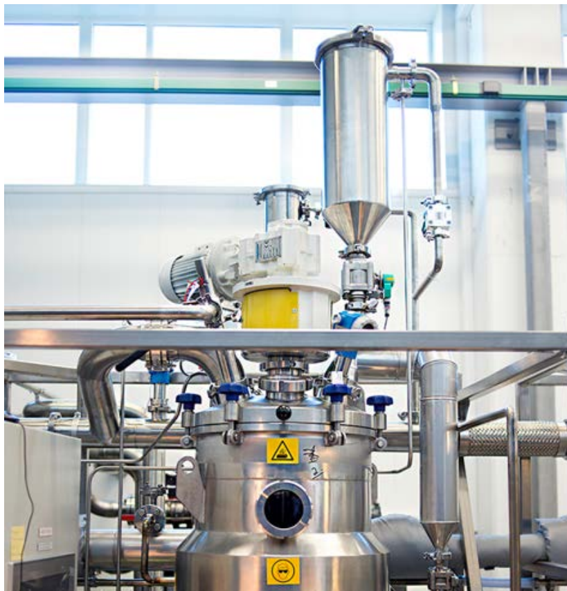
Foto: SINTEFs raffineringsanlegg for marine oljer
