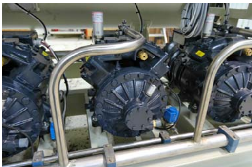
Figur 7 Bilde av kompressorer
