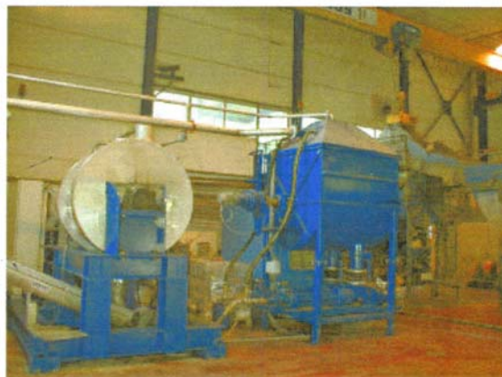
Figur 3 TMD installasjon i drift ved Soilcare AS. Anlegget prosesserer bioslam fra Mongstad raffineriet.
