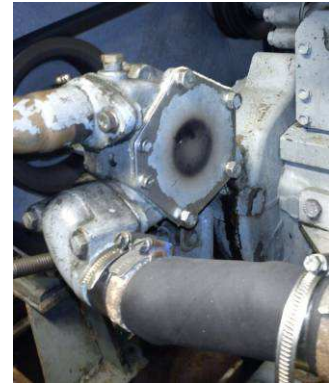
Bilde 7: Pumpe påhengt gir
