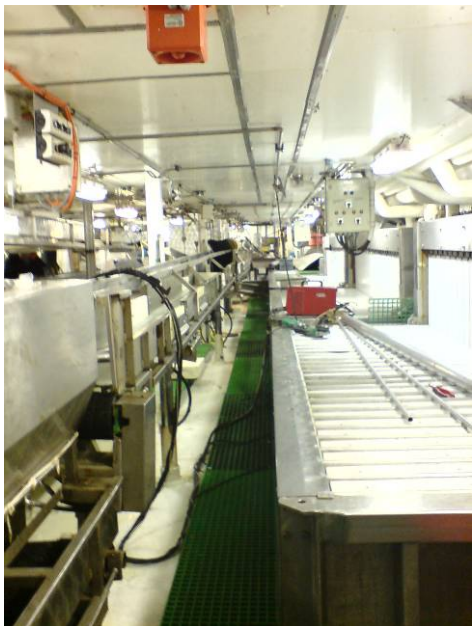
Fra mottaksbinge mot fryserekke (til venstre)
