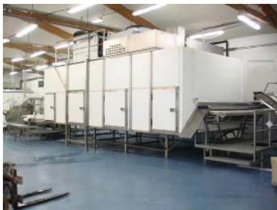
Figur 8. Skinnkjøleren sett fra innmatingsenden og fremover langs ene siden. Trykkvanns- og kuldeanlegg på taket av kjøleren.
