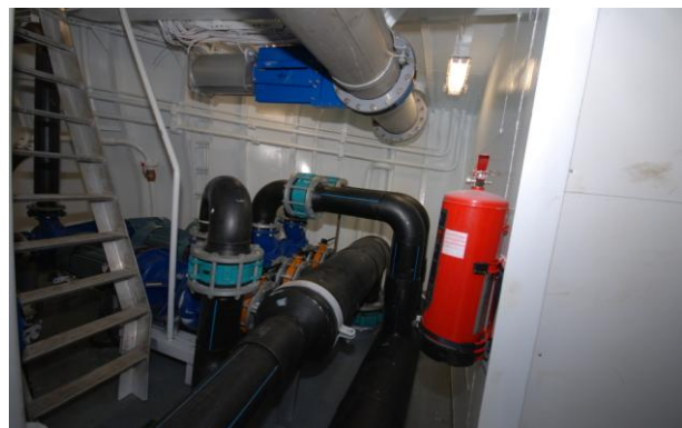
Figur 7. Sjøvannspumper med ND 250 samlestock.
