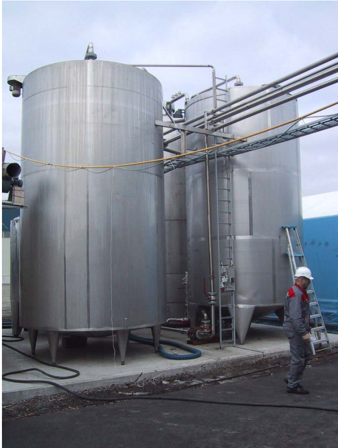
Figur 7. Tankanlegg for mottak av innmat ved Biomega.
